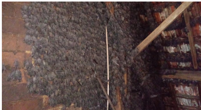
Fotografia 2 – Colônia já instalada no forro
